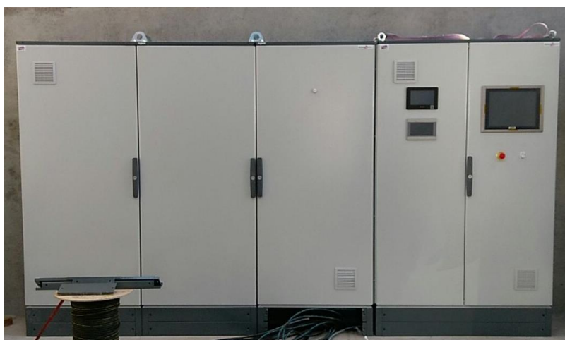
Exemple de bouton poussoir d'arrêt d'urgence sur armoire électrique
